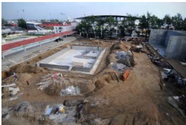
Las obras sin terminar o recortadas por falta de presupuesto.
