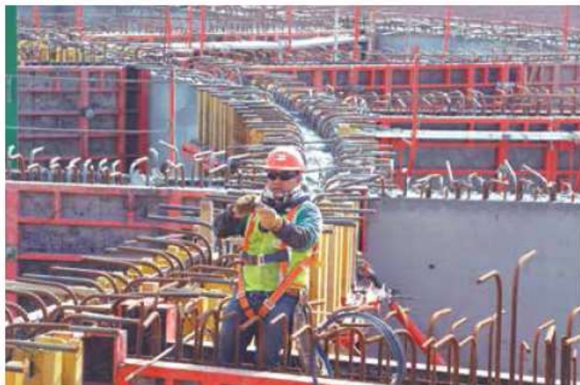
CÁLCULO. Eliminar la obra afectaría a varios grupos aeroportuarios.
