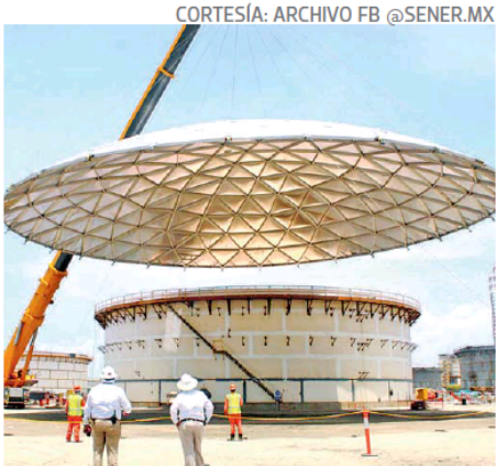
Los tanques de almacenamiento de Dos Bocas
